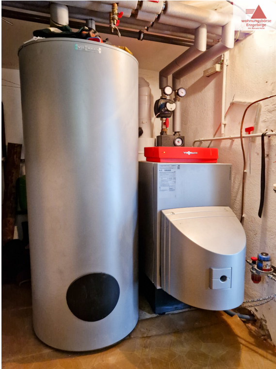
Ölheizung mit Warmwasserboiler
